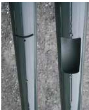
Trappe de visite avec fermeture
